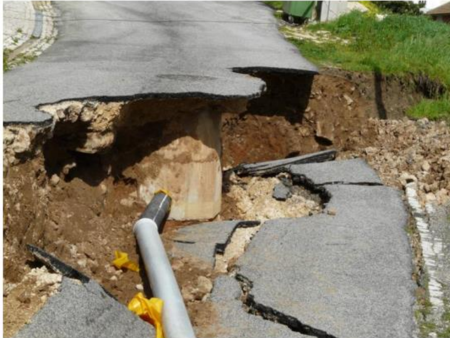
Figura 20 – Deslizamiento de tierra rotacional cerca de Pedra do Ouro, subcuenca de Santana da Carnota.
