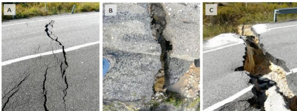
Figura 7 – Apertura de grietas/fracturas que afectan al pavimento y a la estructura de la carretera. A) grietas que se abren hasta 5 cm; B) grietas que se abren entre 5 y 10 cm; C) grietas que se abren hasta 30 cm (parte superior de la foto) y mayores de 30 cm (parte inferior de la foto)
